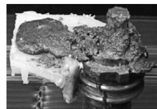
Figura 14 – Foto de um terminal de bateria derretido
